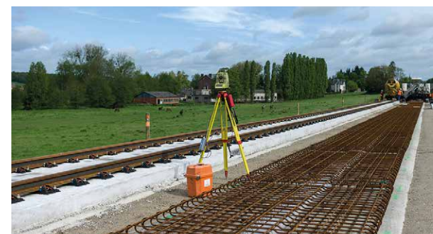
Travaux préparatoires pour la mise en place du pont rail René Cassin à Saint-Jean-de-Maurienne. Construction du pont-rail avant poussage
